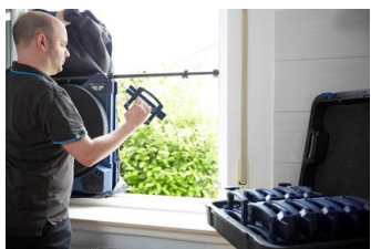
图 17：用伸缩杆将主机固定在窗框上
